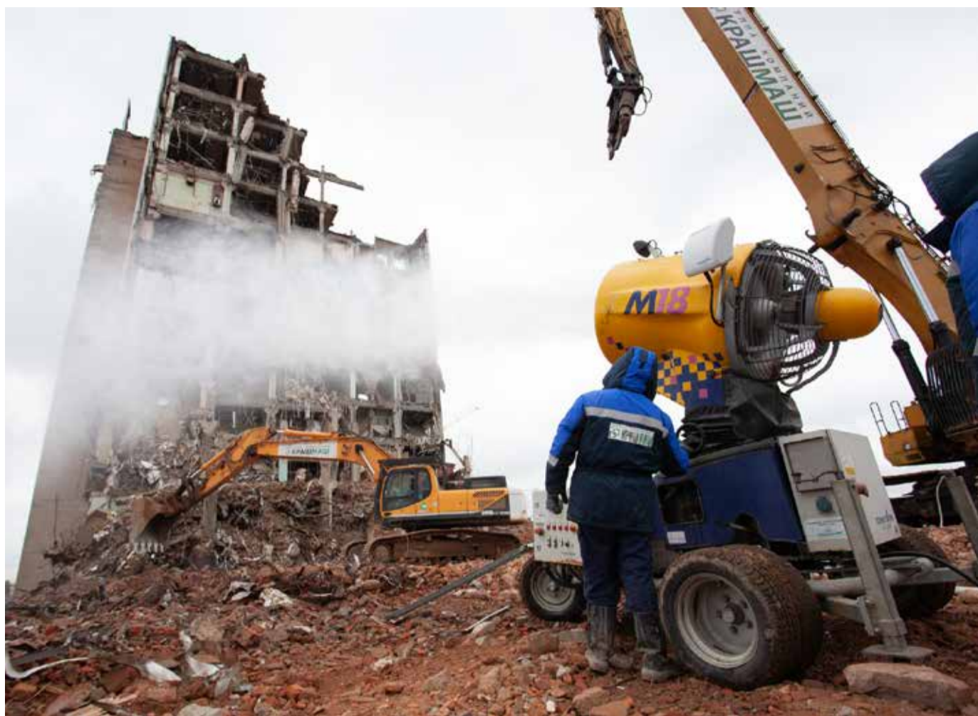
Компания «КрашМаш» в сжатые сроки снесла 70-метровое здание на пересечении Волоколамского шоссе и МКАД
